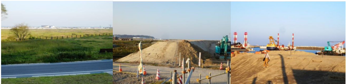
左：津波被災地全景 中央奥に見えるのが請戸小学校 中：防潮堤の嵩上げ工事 右：請戸漁港の復旧工事
