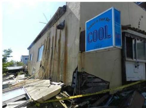
解体処理が行われずに残ったままの家屋
