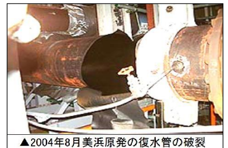
▲2004年8月美浜原発の復水管の破裂
