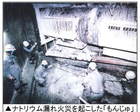
▲ナトリウム漏れ火災を起こした「もんじゅ」
