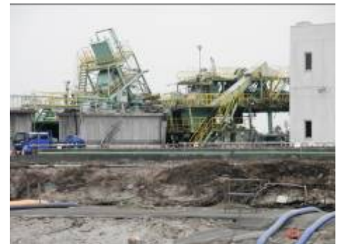
被災した処理場(仙台市)
