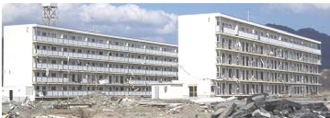
P2 RC5階建てアパート、4階まで被害、手前棟の被害が顕著、手前右側が海岸、陸前高田
