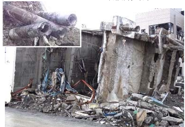
P7 横転のRC2F 建建物、くい破損、女川
