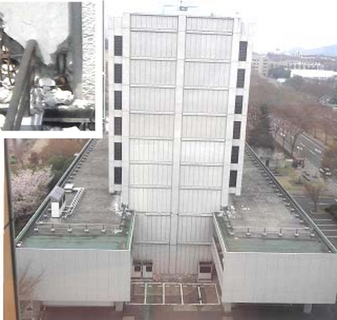
P9 SRC造建物の被害、新耐震以前のもので耐震補強したもの。柱増部拡大は写真左
