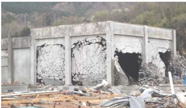
P4 無窓のRC 倉庫、壁の被害、手前左側が海岸、女川
