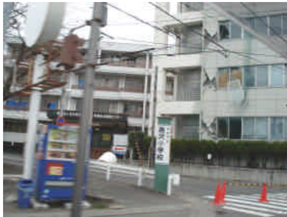
事務所ビルの被害
