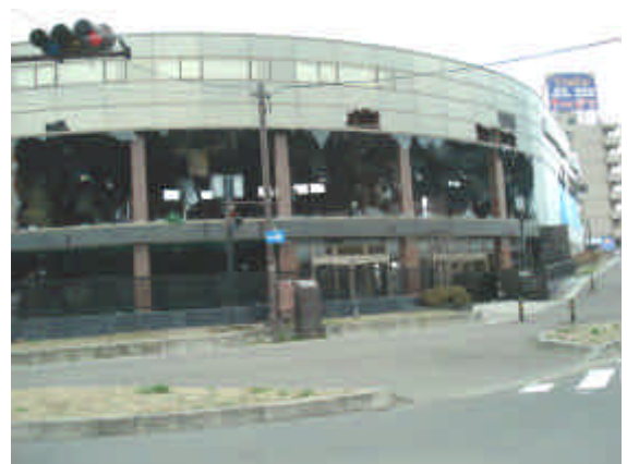
自動車ショールームの被害
